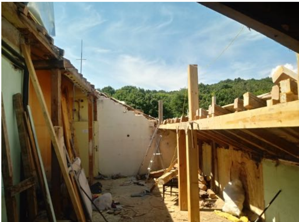
Sehr viel freier Himmel über dem Berghaus Mladost bei Targoviste, – aber hier war die Reparatur des Dachstocks bereits voll im Gang. Inzwischen ist das unter Schneedruck eingekrachte Dach neu aufgebaut und gedeckt.
